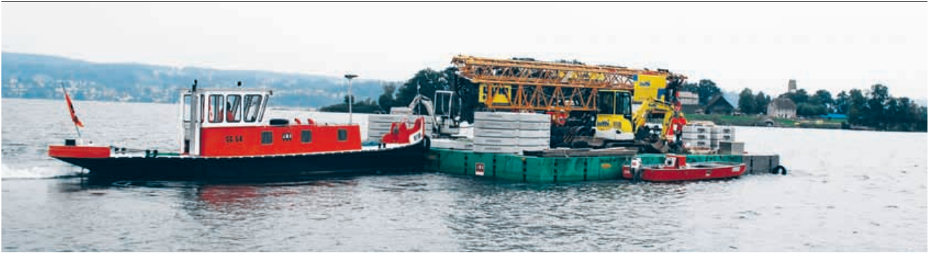
Die Überfahrt auf die Insel Ufnau dauerte nur rund eine Viertelstunde – ein Klacks im Vergleich zum Aufwand beim Be- und Entladen.
