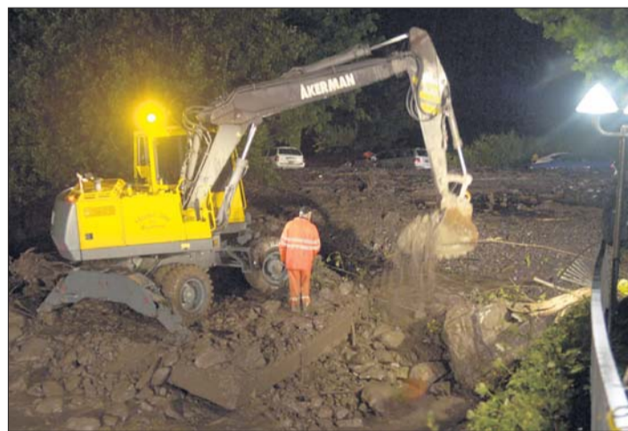
Zugedeckt: Kantonsstrasse zwischen Brunnen und Gersau. (key)
